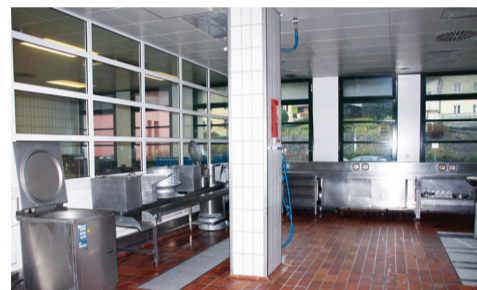
In der jetzigen Fleisch- und Gemüsevorbereitung wird ab Mai 2010 die Notküche untergebracht werden.
